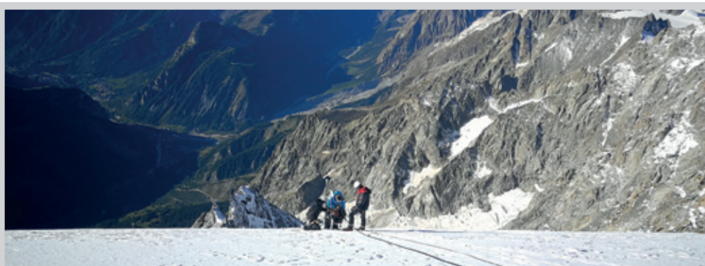
Fasi di installazione della rete di monitoraggio del seracco Whympier; il seracco Whympier e il ghiacciaio di Planpincieux sono controllati da una delle più sofisticate reti di monitoraggio del mondo, frutto della collaborazione tra Fondazione Montagna Sicura, Regione Valle d'Aosta e CNR IRPI. Foto Daniele Giordan
